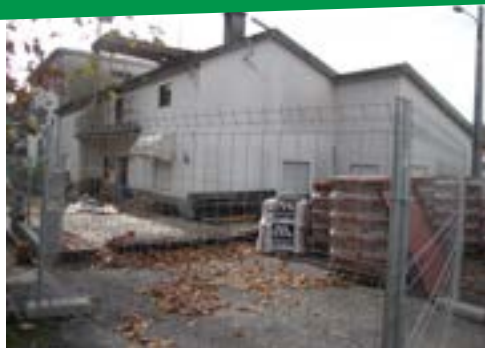
Grandes obras de restauração, na Sede do Núcleo de Unhais da Serra/Covilhã
